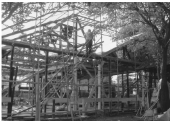
作家集団によって再生工事中の森芳工場。壁も天井もいねいに手作業で解体され、骨組みだけになったところ。ブーリーは象徴として残された
