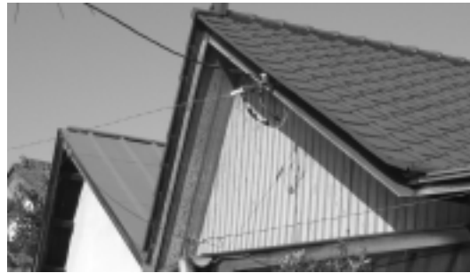
(写真5) 連によって屋根材が異なる事例
