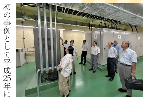
災害時の停電に対応する蓄電池設備を見学する参加者
